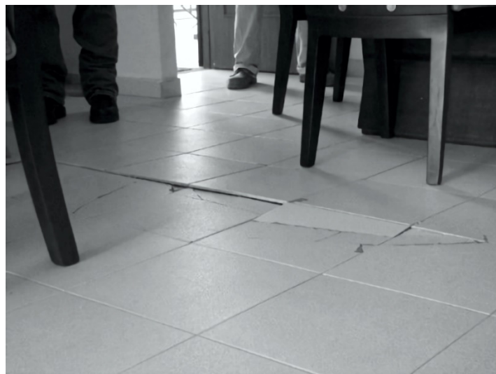
Figura 6. Falla en revestimientos de cerámica en pisos.
