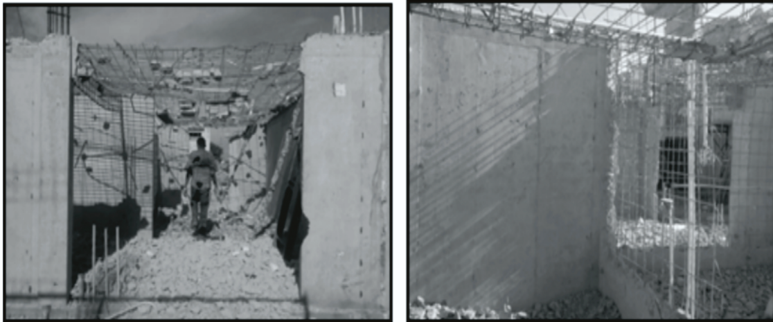
Figura 2. Contaminación en la mezcla del concreto.
