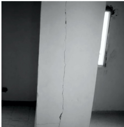
Figura 4. Falla en columnas.
